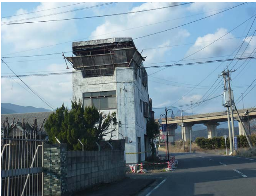
西祓川弥生会館横建物 建物危険箇所 歩道が通れず危険
