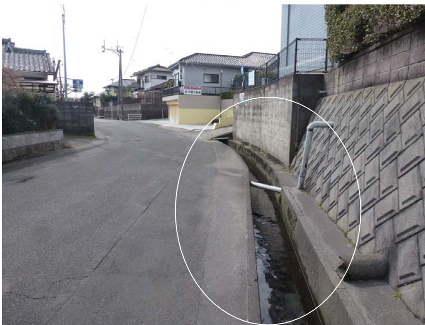
雨の日水量が多く危険であり、側溝蓋かフェンスの要望
